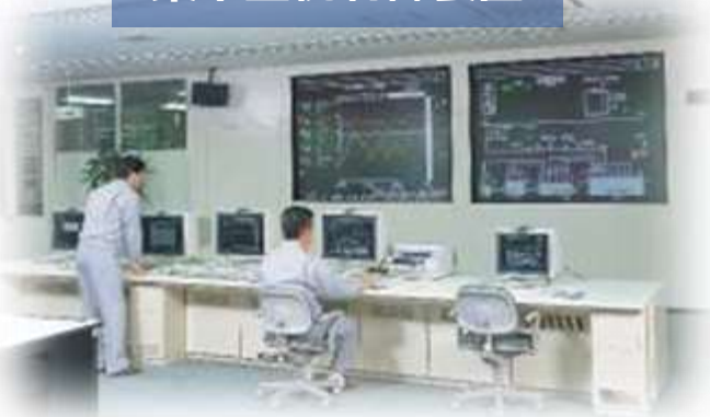
集中監視制御装置
