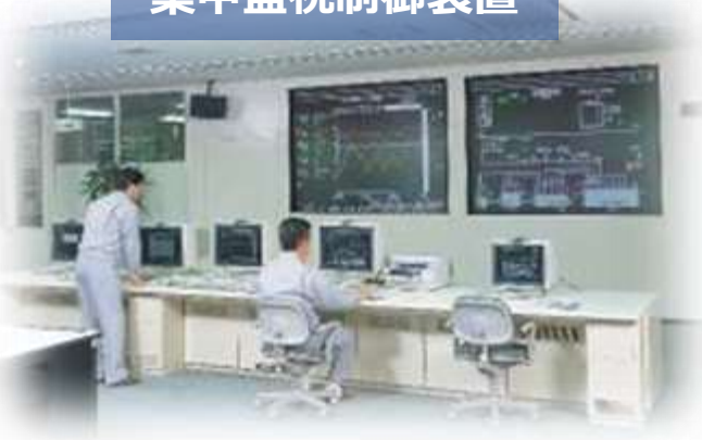
集中監視制御装置
