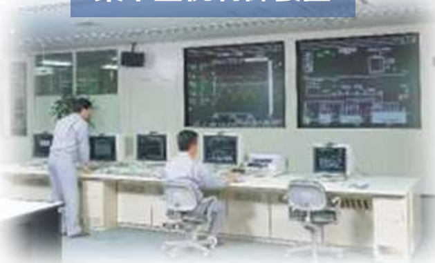
集中監視制御装置
