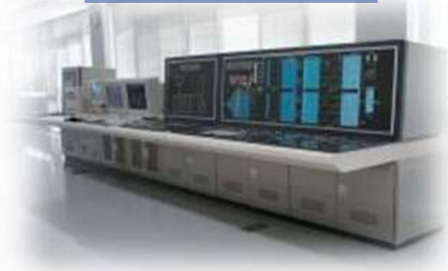
集中監視制御装置
